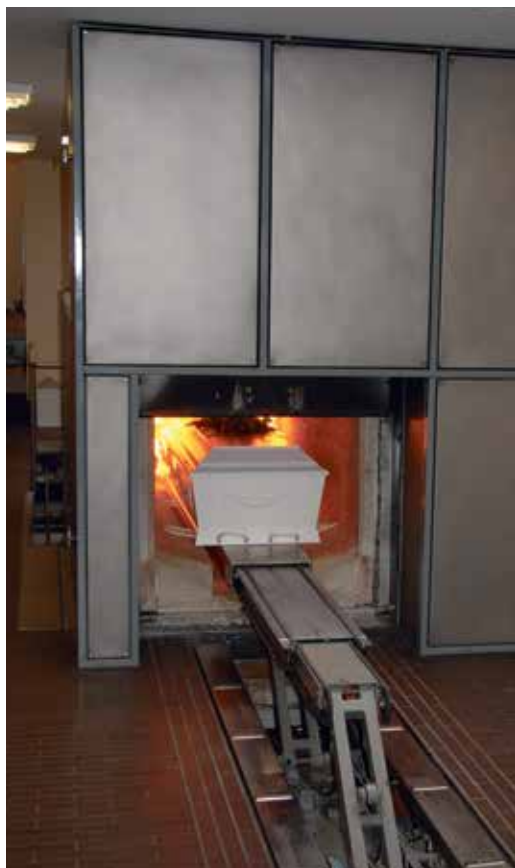
Krematorieovn med indsætningsplanke
