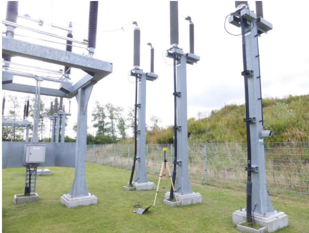
Måling 8 i Kildebrønde
